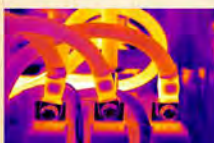
電源線路檢測
