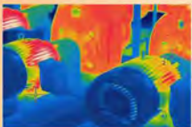
轉動機械設備
